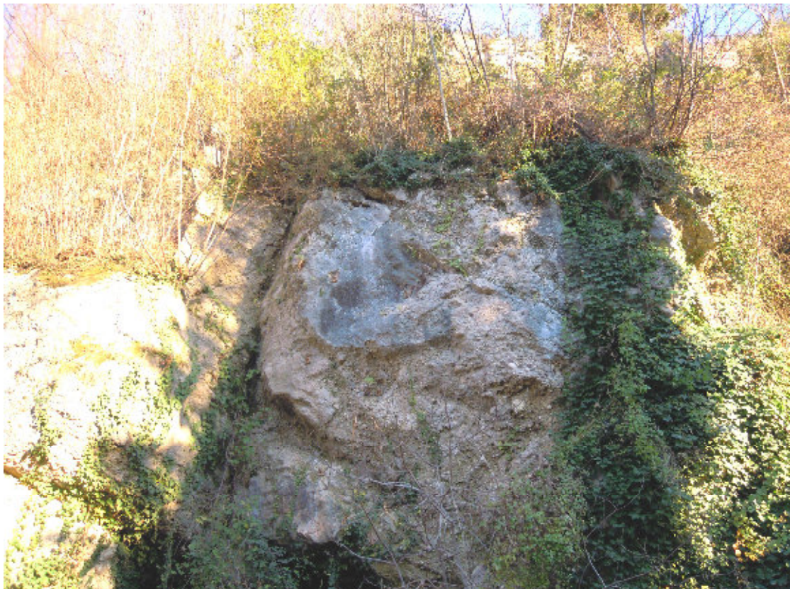
PARETE ROCCIOSA OGGETTO DI INTERVENTO DI CONSOLIDAMENTO ALL'ALTEZZA DEL 2° TORNANTE DELLA STRADA CHE PORTA ALLA SOMMITA' DEL COLLE DI OSOPPO
