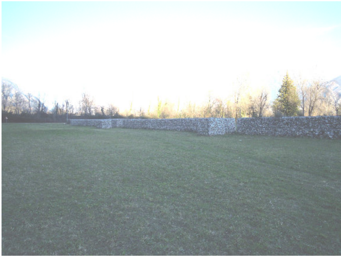
BARRIERA PARAMASSI IN GABBIONI ALLE PENDICI NORD-ORIENTALI DEL COLLE DI OSOPPO
