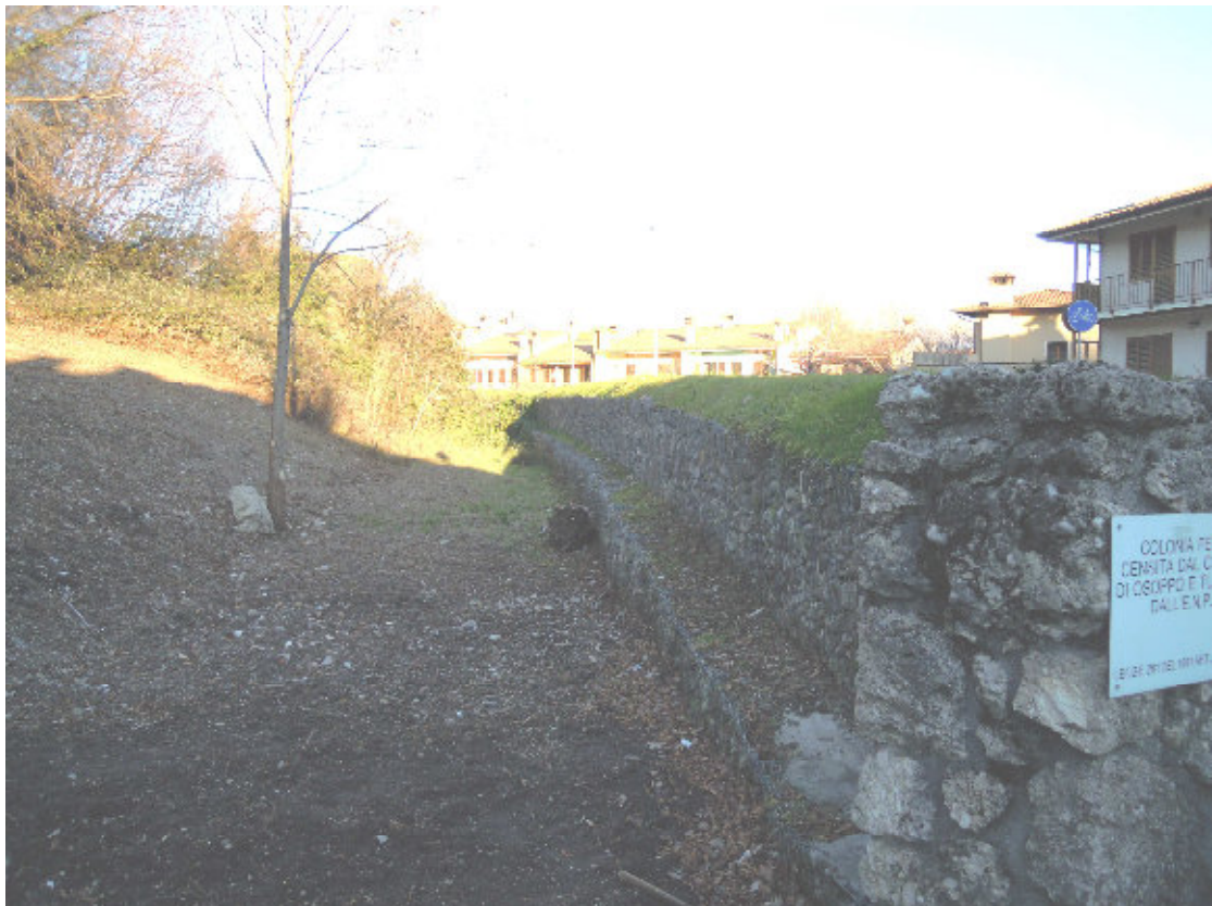
MURO PARAMASSI ALL'INIZIO DI VIA MOSCOVIA
