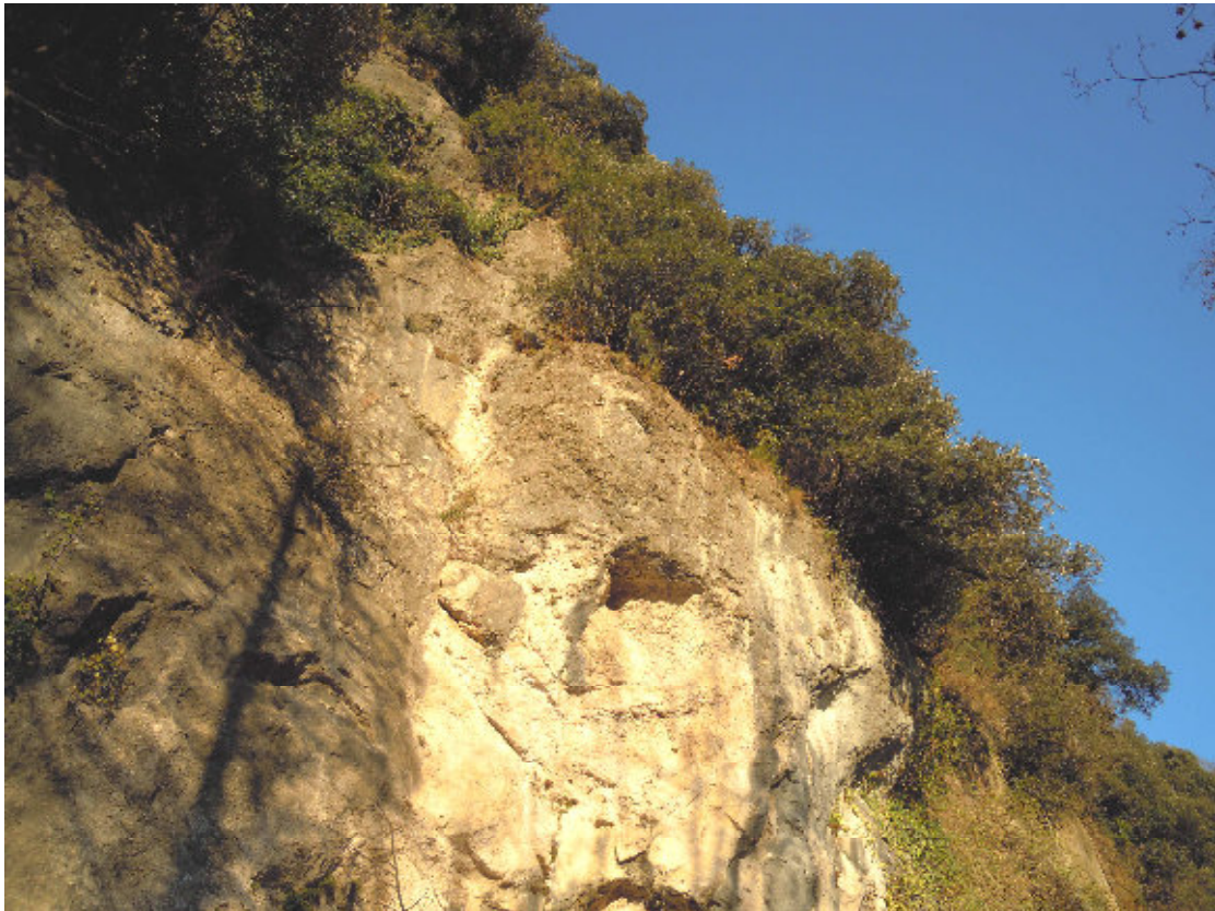
PARETE ROCCIOSA OGGETTO DI INTERVENTO DI CONSOLIDAMENTO ALL'ALTEZZA DEL 1° TORNANTE DELLA STRADA CHE PORTA ALLA SOMMITA' DEL COLLE DI OSOPPO
